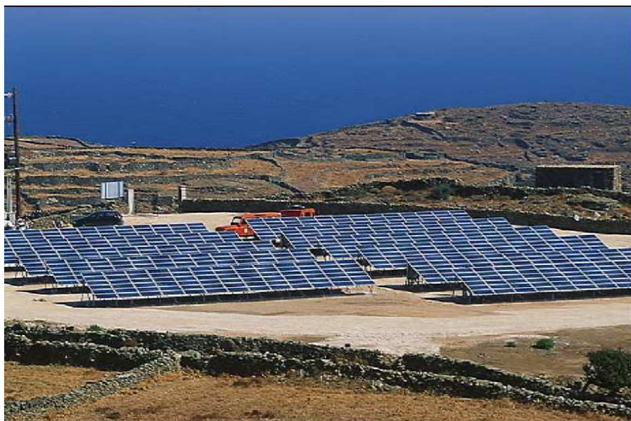
Φ/Β 60 KWp στην Σίφνο
